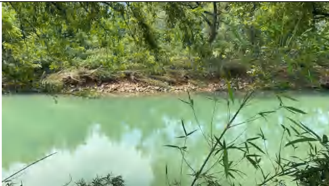
联丰村 3 段，洪水冲刷造成岸坡坍塌
