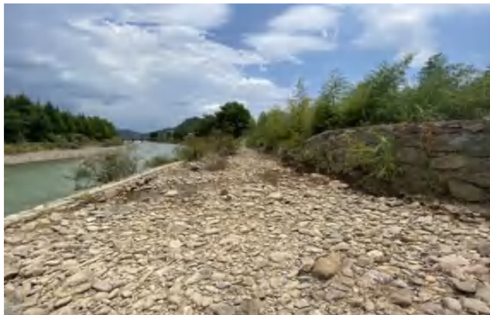
大史村 2 段挡墙基础冲刷
