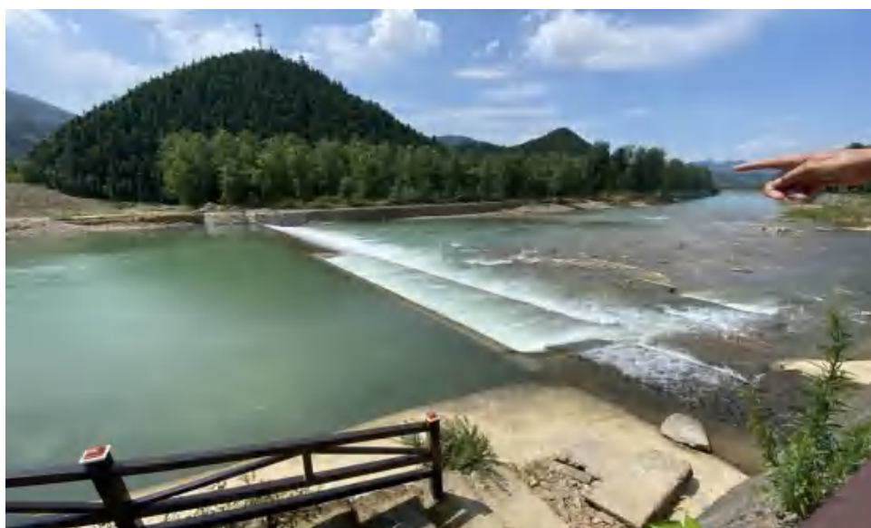
图为马旭溪干流，大路边村堰因洪水冲毁，右坝部分堰体严重损坏
