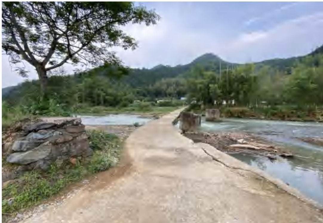
原有机耕桥水毁，图为村委自行浇筑砼路面，路面下埋置涵管
