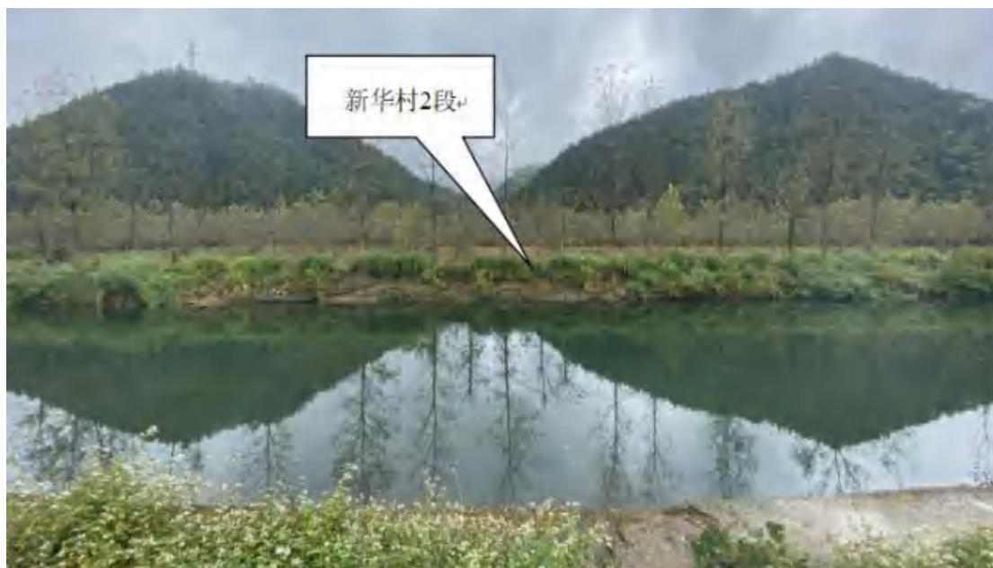
新华村 2 段、6.30 洪水造成岸坡坍塌
