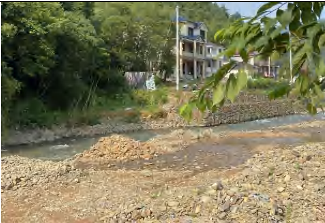
右岸已建挡墙水毁
