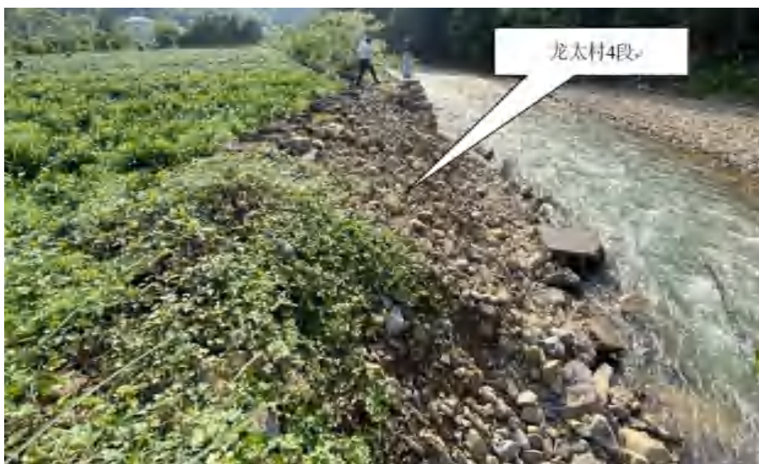
龙太村 4 段、左岸已建挡墙水毁
