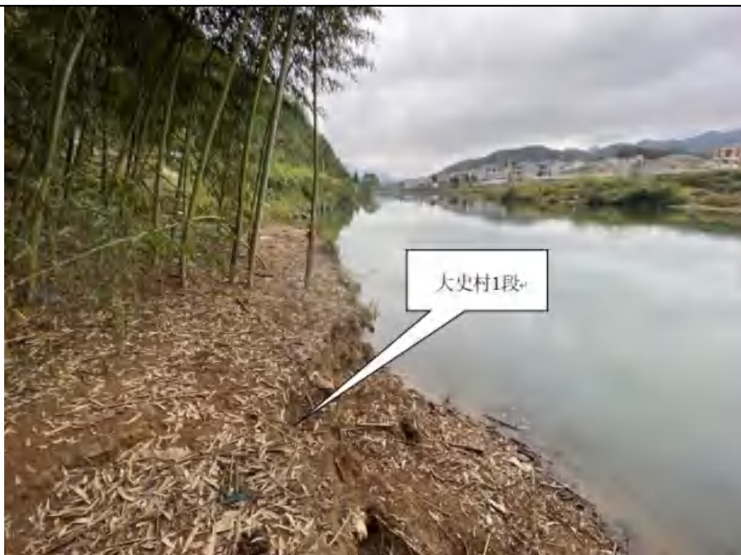
大史村 1 段现状护岸被冲毁
