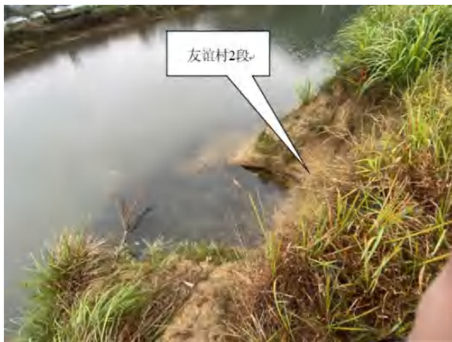
友谊村 2 段现状护岸被洪水掏空
