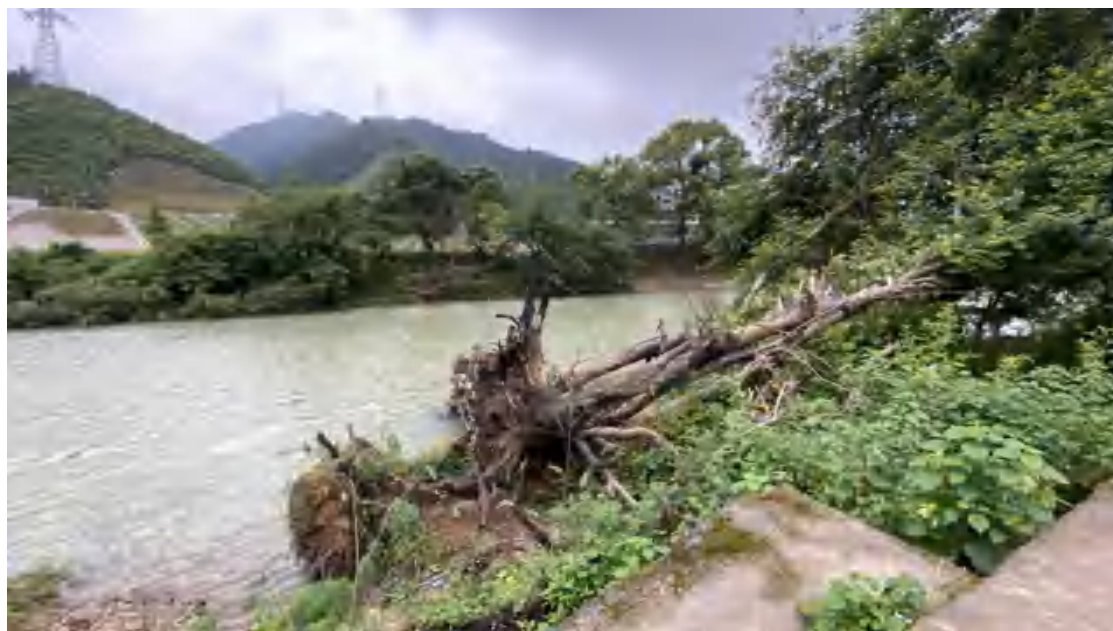
王家村 2 段，现状局部挡墙水毁坍塌，路面冲毁
